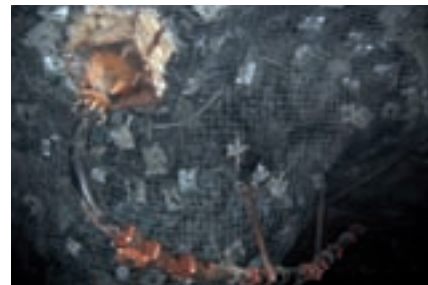
Eintritt der Förderleitung von über Tage in die Strecke und Weiterführung zum Versatzort
