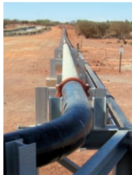
Übertägige Rohrleitung zum Transport des Versatzmaterials
