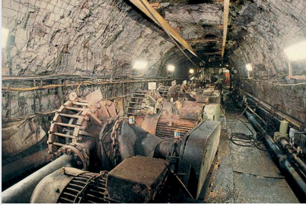
686 metre kotta yer alan daha önceki pis su çamuru pompa oda görünümü. 12 adet tek kademeli santrifüj pompalar seri olarak bağlanmıştır ve 141 metre yukarıdaki bir sonraki 545 metre ters kota kumlu su nakletmektedir.
